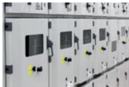
Prévention des risques de court-circuit et d'échauffement
